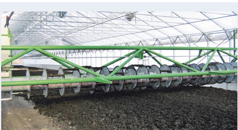
En plus de l'action du soleil sur la serre, le séchage est facilité par le scarificateur qui «aère» les boues.
